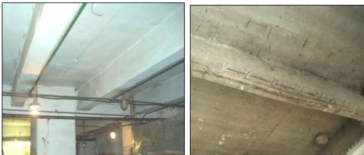
Рис. 2 – Конструктивное решение и состояние элементов ребристых перекрытий
