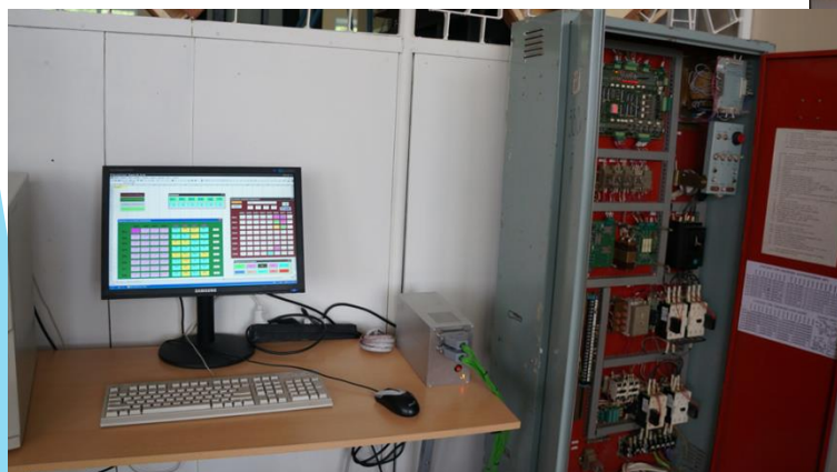
Проверочно-испытательный стенд на уровень квалификации электромеханика
