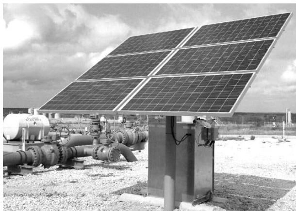
Рис. 7. Установка катодной защиты с фотоэлектрической системой электропитания
