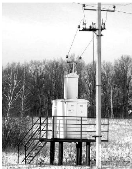
Рис. 5. Высоковольтная установка катодной защиты
