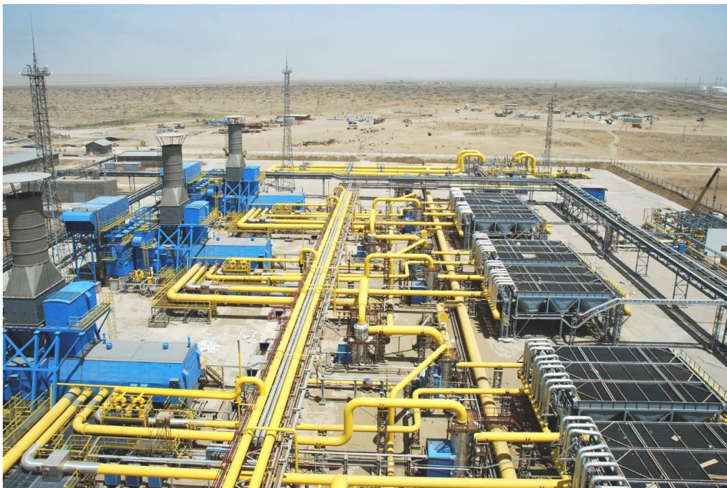
Рис. 1. Общий вид дожимной компрессорной станции
