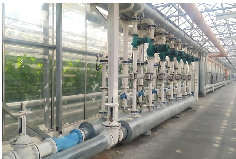
Рис. 2. Электрооборудование системы управления циркуляцией воды в контурах регистров отопления
